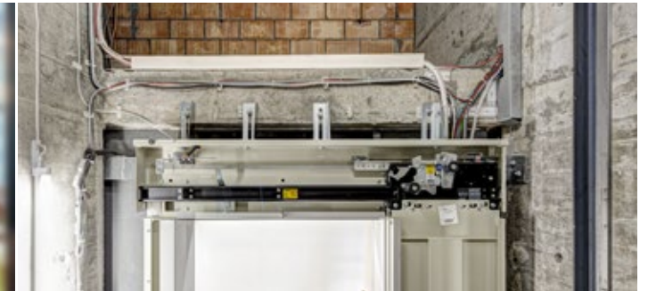
Schindler 3400 Plus: modernisation d'ascenseur pour un confort maximal
