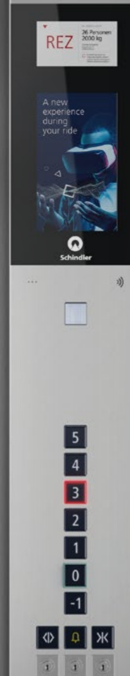
Pulsantiera di cabina, tutta altezza
