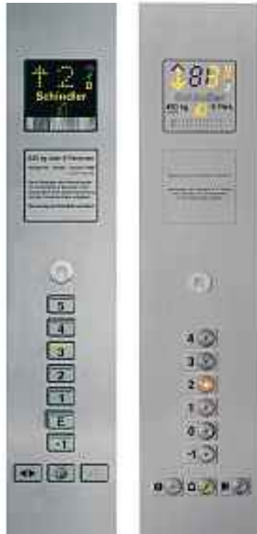
Kabinentableaus über die halbe Kabinenhöhe – Edelstahl – vandalensicher
