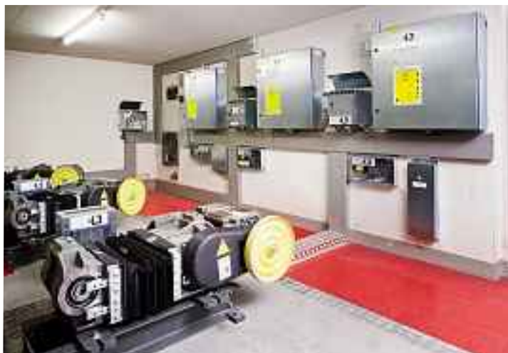
DR SGB 142 con comando CO MX per gruppo di 3 ascensori in stabile commerciale
