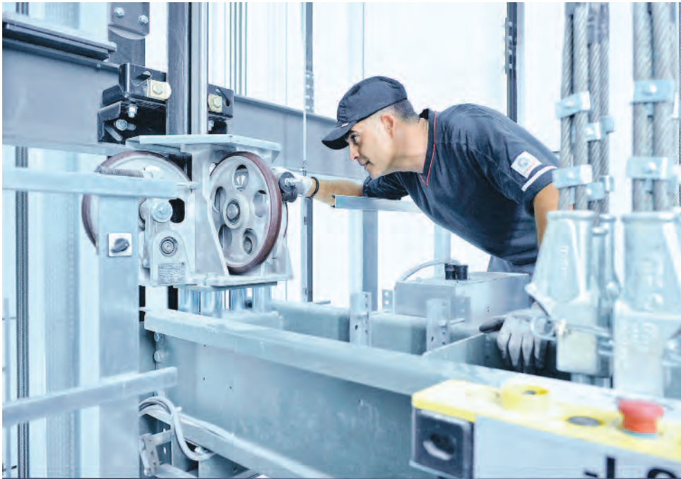
Hohe Servicekompetenz, aber auch die Anpassung an die heutigen technischen Vorschriften garantieren eine optimale Sicherheit des Aufzuges.
